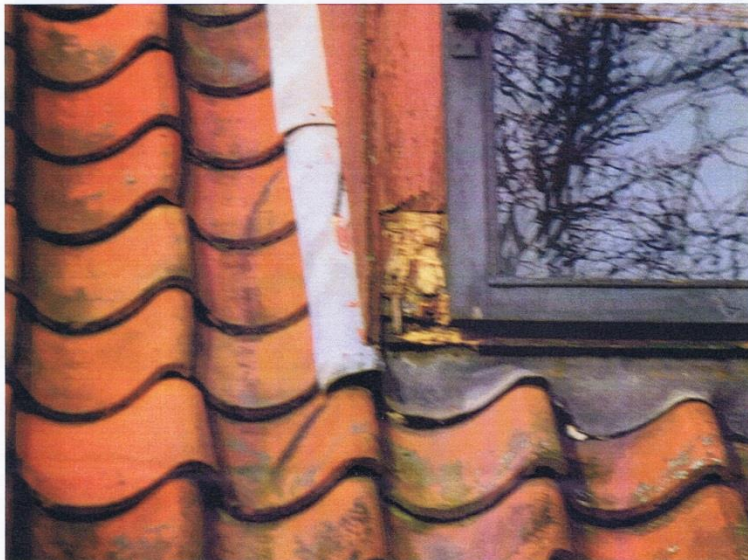
Råd i kvist vindue – manglende vedligehold
