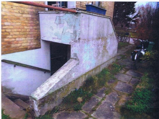
Fugtskadede trappe - dårlig vedligehold
