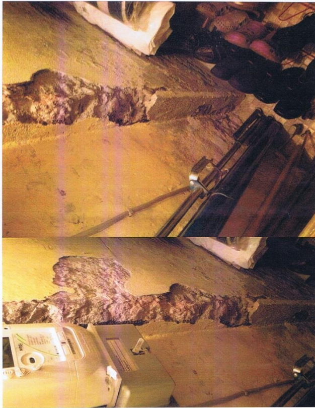
Pudsskader i kælder – nej til rep fra bestyrelse
