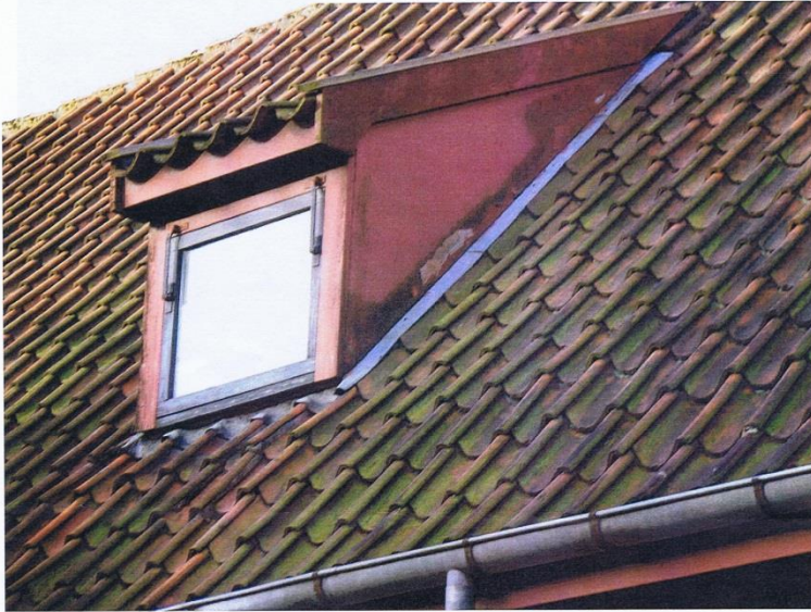
Kvist under nedbrydning – manglende vedligehold
