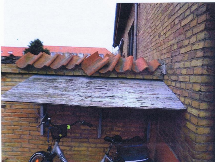
Løse teglsten på havemur
