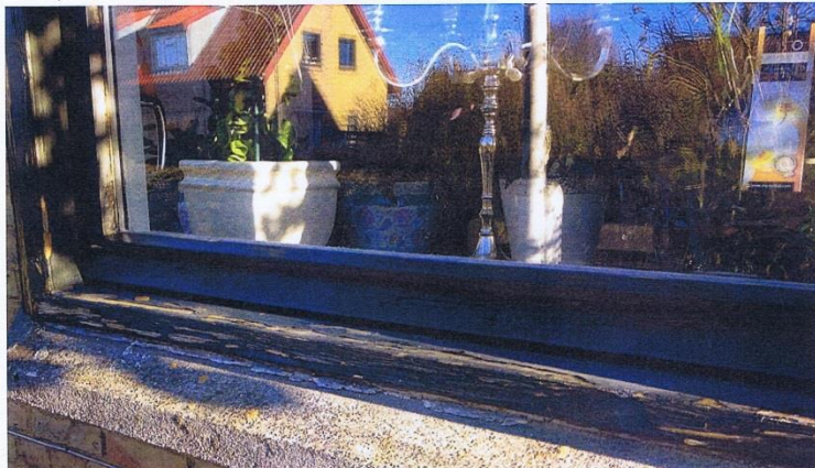
Karnap vindue utæt og ikke vedligeholdt
