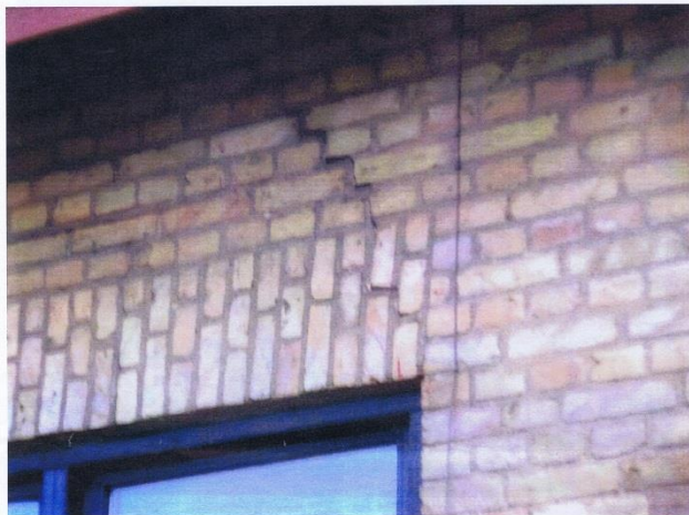
Sætningsskader på hus
